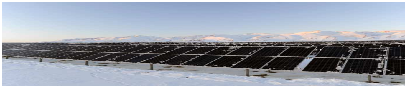
Кош-Агачская солнечная электростанция (СЭС)
